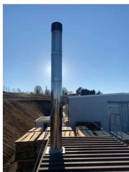
Figure 7: Cheminée pour l'évacuation de la fumée
