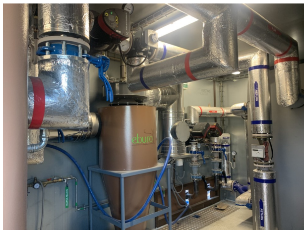
Figure 4: Système hydraulique reliant la cabine EBURO au réseau d'eau de la ville.
