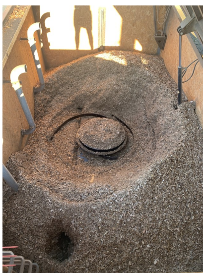
Figure 6: Silo pour pellet ou granulé alimentant la chaudière
