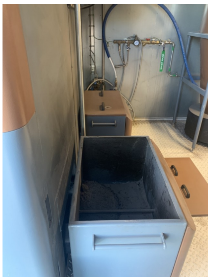
Figure 5: Réservoir de cendres en sortie de chaudière
