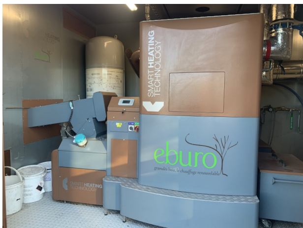
Figure 3: Chaudière contenue dans la cabine EBURO
